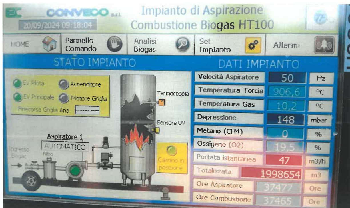
Foto 9: particolare pannello di controllo centrale termica – settembre
