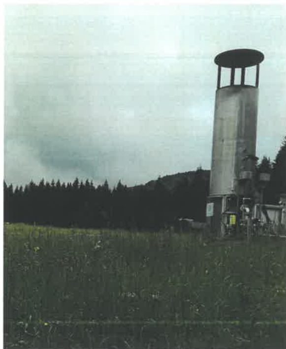
Foto 3: centrale di combustione – giugno
