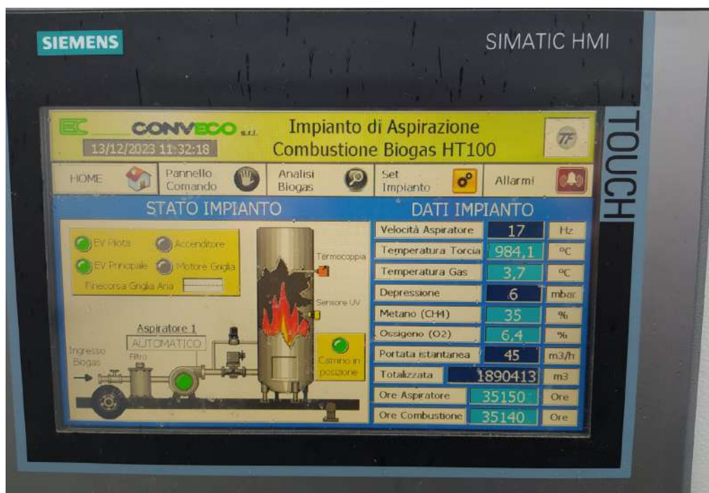
Foto 9: particolare pannello di controllo centrale termica – dicembre
