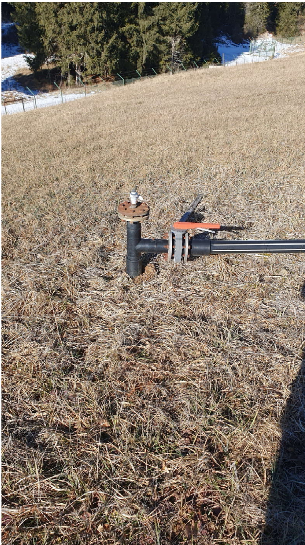
Foto 12: particolare pozzo captazione biogas - gennaio
